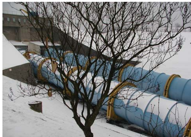
Rys.7 Rurociągi derywacyjne Elektrowni Wodnej Koronowo na Brdzie (moc: 26 MW; spad: 26 m)
