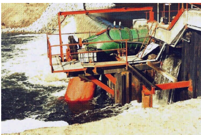
Rys.11 Hydrozespół z poziomą turbiną lewarową w małej elektrowni wodnej Jaracz na rzece Wełna w pobliżu Rogoźna Wielkopolskiego
